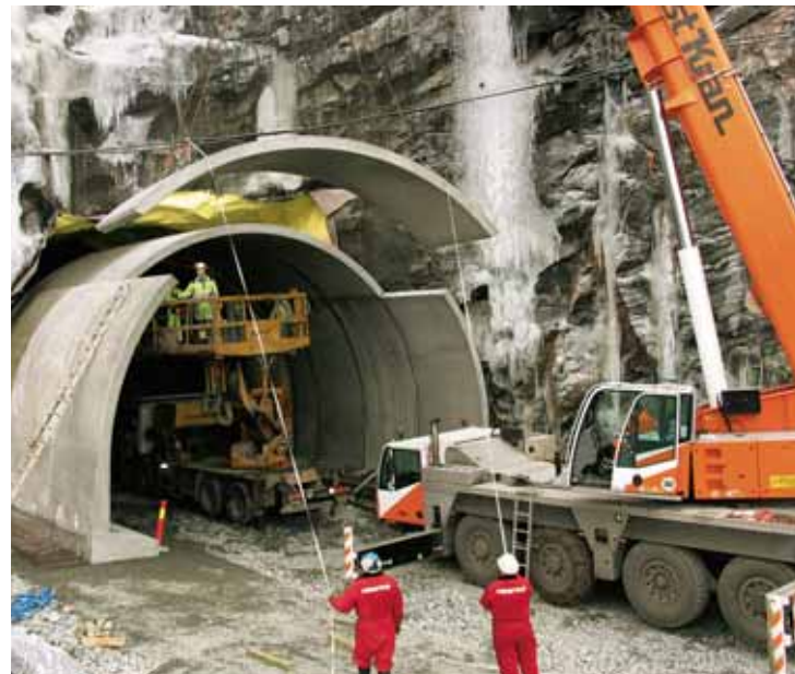
Åpning avlyst: Snorklippingen var bare én dag unna da Statens vegvesen oppdaget at alt ikke var som det skulle være med Skrøtunnelen. Her fra byggingen av den andre tunnelportalen. (Foto: Reidun Øverland)
