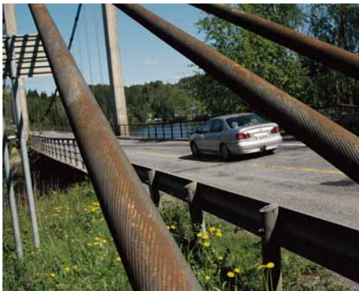
Rustrød: Vammabrua på rv. 115 var i våres rustet etter mange års utsatt vedlikehold. (Foto: Håkon Aurlien)
