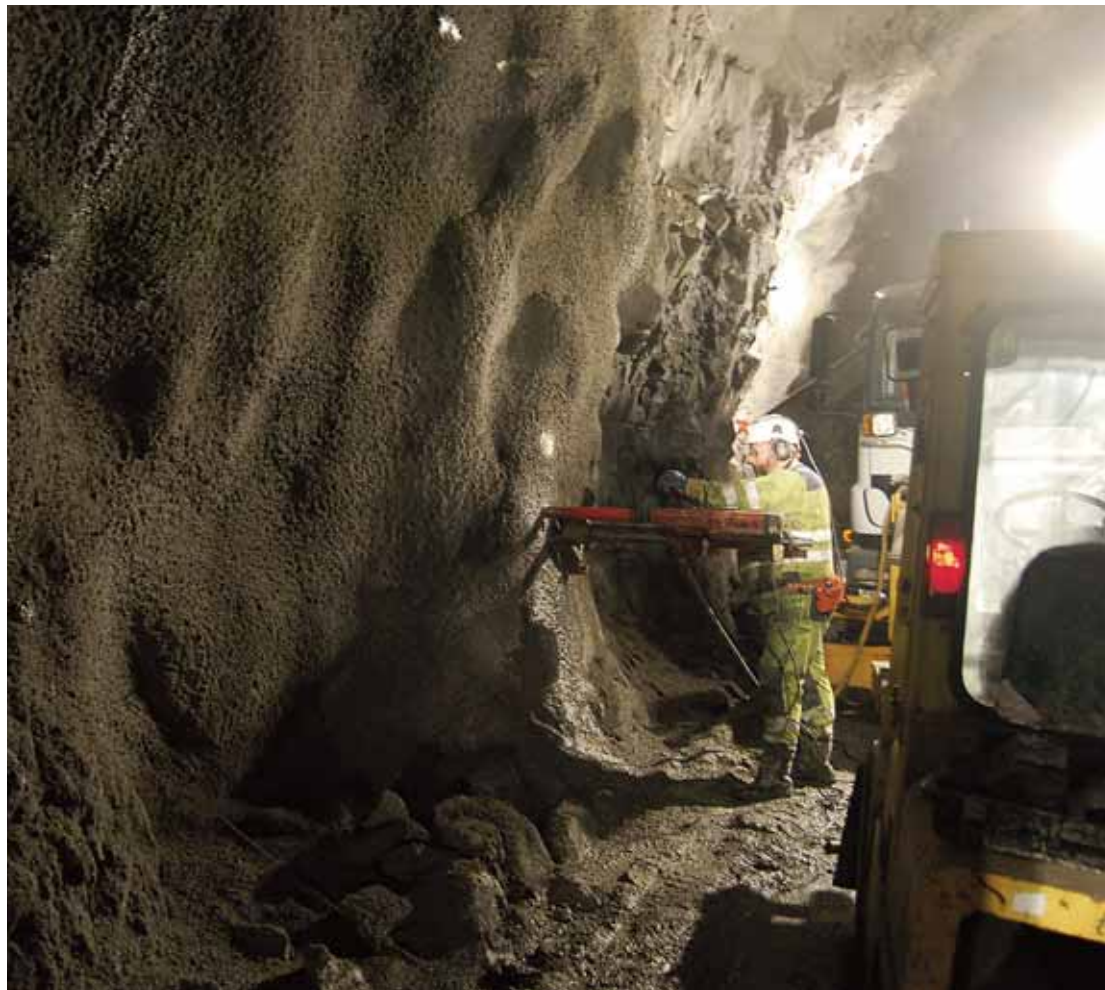
Problemet løst: PE-skummet med sprøytebetong i Langnestunnelen har skapt mye hodebry i Statens vegvesen. (Foto: Giselle Jensen)
