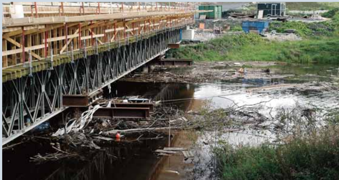
Storflom: Vannet i Simoa steg to meter over normalen, og stod midtveis opp på dragerne, og tok med mye tømmer og skrot på veien. Men nybrua ved Haugfoss tålte trøkkene. (Foto: Kjell Wold)
