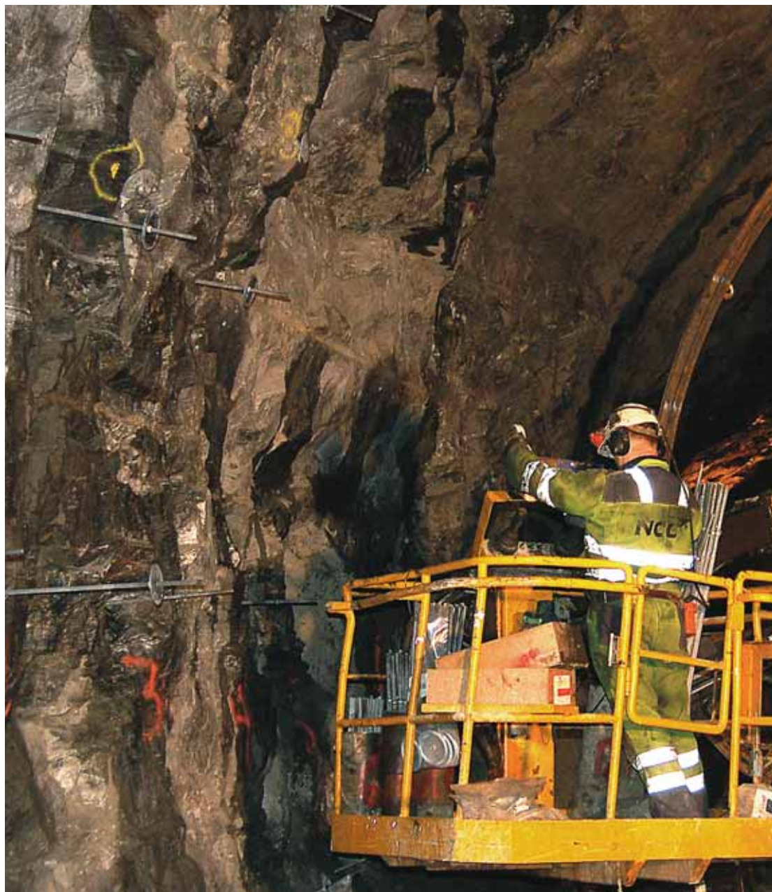
Langnestunnelen: 27. juni leverer Vegvesenet forslag til løsning for destruksjon av avfallet fra Langnestunnelen. Problemet er PE-skum med bromerte flammehemmere festet til sprøytebetong. (Foto: Tommy Taftø)
