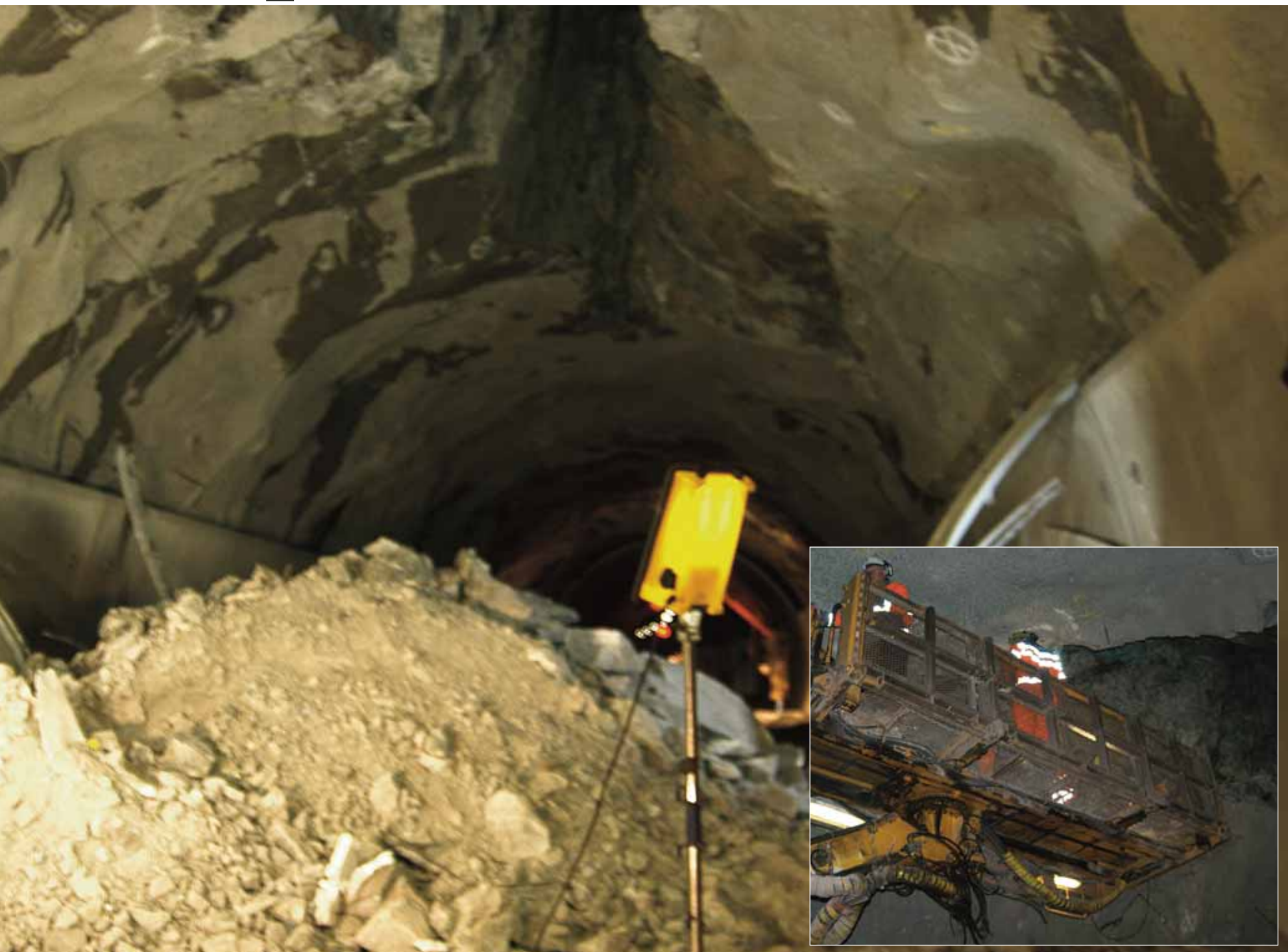
18 Hanekleivtunnelens sørgående løp 25. desember 2006. Her fra oppryddingsarbeidet i forrige uke. (Foto: Kjell Wold) 19 inspeksjon i tunnelen i forrige uke. Lite bilde til høyre (Foto: Kjell Wold)
