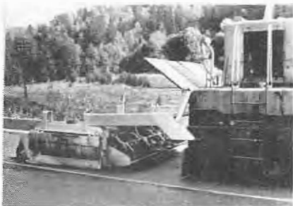
Heateren sett litt lenger fra
