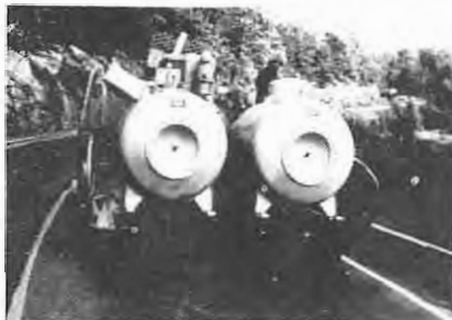
2 propangassbeholdere montert foran på utleggeren, hver rommer ca. 1500 liter propan.
