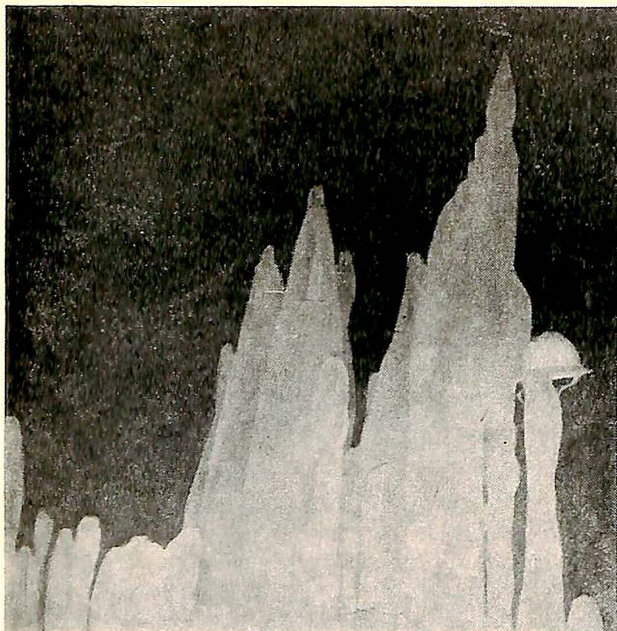
Fig. 8. Isforekomster i Prestegårdstunnelen april 1966.
