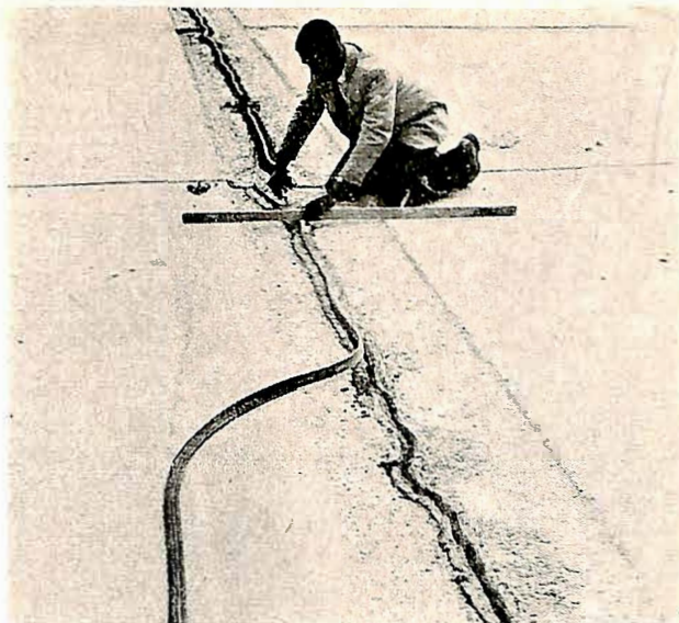
Fig. 9. Plassering av en armert neopren forseglingslist i en langsgående revne på Motorveg M 1.
