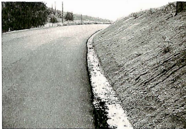
Fig. 3. Veg breddeutvidet og forsterket for legging av fast dekke. Vannet blir her stående så høyt at oppbløting av bærelaget og ødeleggelse av asfaltdekket er overveiende sannsynlig.
