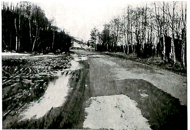
Fig. 1. Eldre veg med asfaltdekke. Vannet har ikke avløp i vårløsningen. Bærelaget bløtes opp og asfaltdekket går i stykker.
