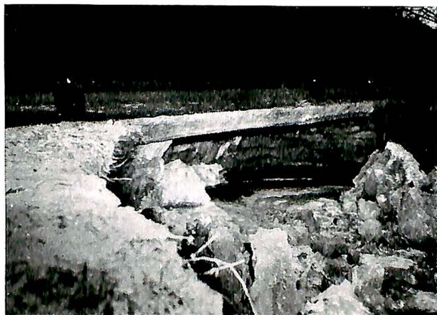
Fig. 15. Fra en soil-cementvei i Tennessee som ble vasket ut i 1 m bredde og 2,5 m lengde uten at soil-cementdekket gikk i stykker, til tross for at trafikken pågikk en tid før man oppdaget hva som var hendt.
