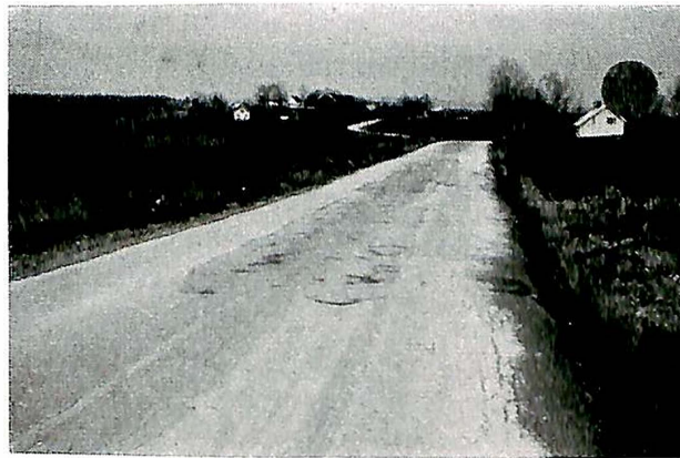
Fig. 2. Nytt asfaltdekke som er ødelagt av telehiving.
