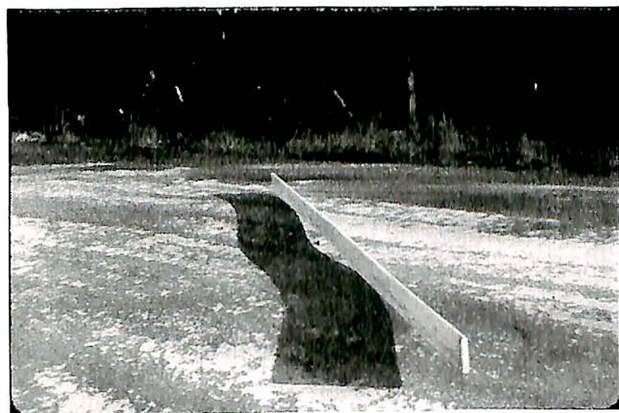
Fig. 1. Teleløftning i asfaltdekke som har gjentatt seg hvert år uten at dekket har tatt skade av det.
