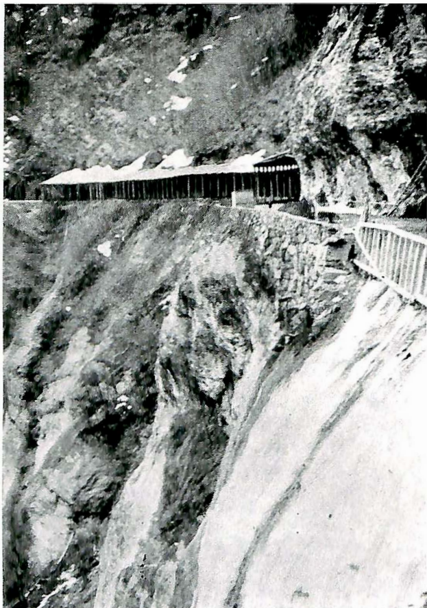
Fig. 7. Tokagjelet. ved stedet hvor vegen raste ut i 1953 (i forgrunnen). Mellom rasstedet og overbygget ser en at fjellet utenfor vegen ligger på sleppe med fall mot gjelet.
