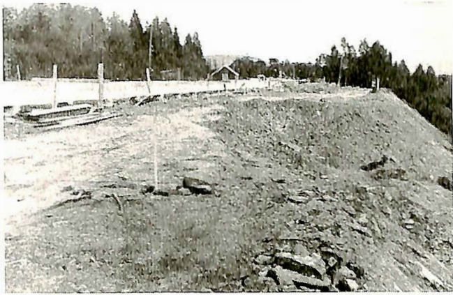
Fig. 8. Vakås 1954. Fyllmassen var stein og sank ned i den underliggende leiren. Foto i ytre spors retning.
