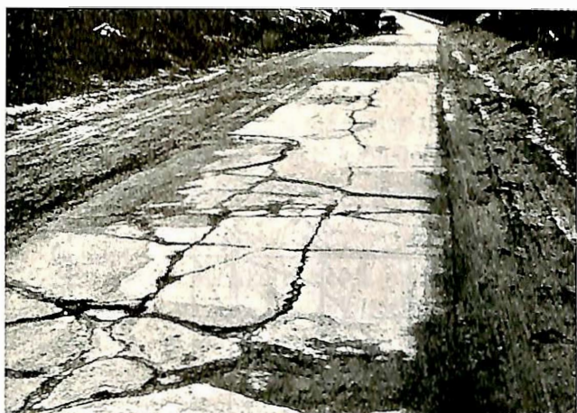
Fig. 2. Betong på nyplanering med ujevnt hvide grunn.
