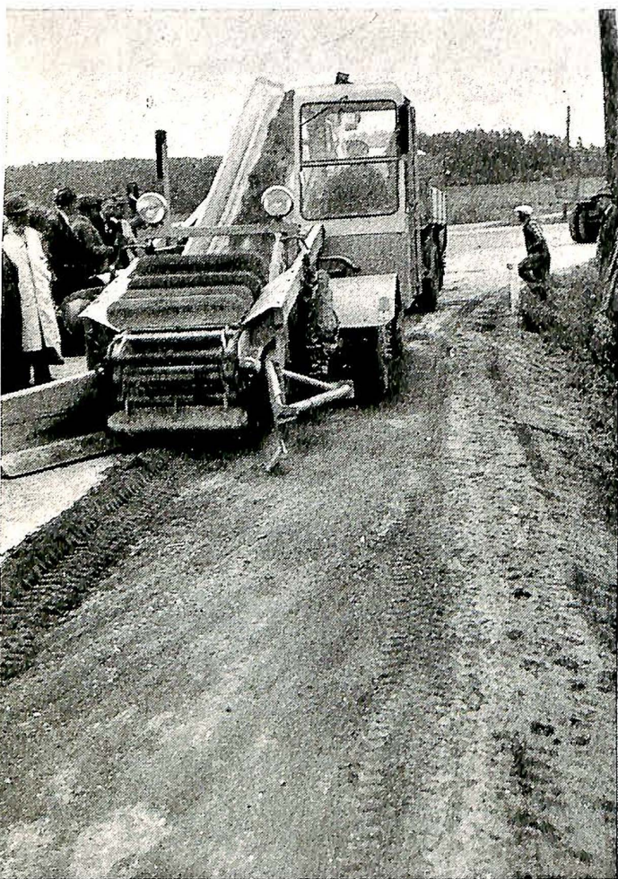
Fig. 17 a. Lessing av jordstreng. Lengst borte køyrer høvelen som legg torvkanten inn på veg køyrebana. Deretter kjem lessemaskina med paternosterverk som fører jordstrengen opp og atover slik at jorda (grusen) dett ned på lastebilen som rygger etter (kobia til) lessemaskina.
