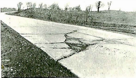
Fig. 1. Betongvei ødelagt av telehiving i Michigan.
