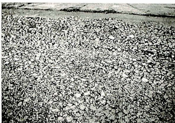
Øverst: 20—45 mm grovsingel nedvalset i det løse gruslag. Nederst: Forsterket pedrolittdekke på Langbrodalsveien. 3 cm nedvalset stenlag ferdig til penetrering med tjære.
