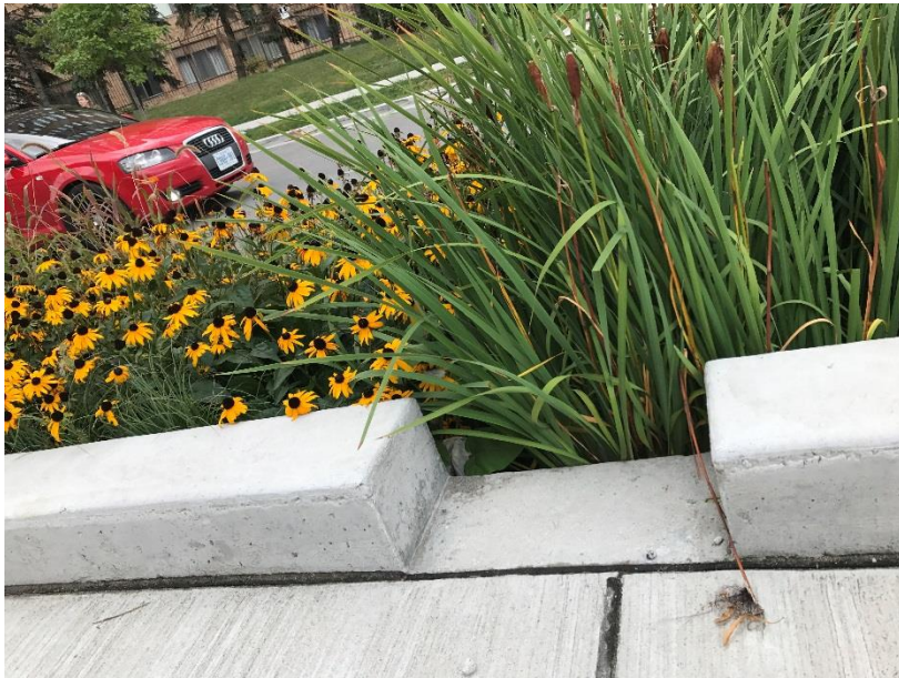
Det er laget forsenkninger i kanten rundt regnbedet slik at vann slipper inn.
