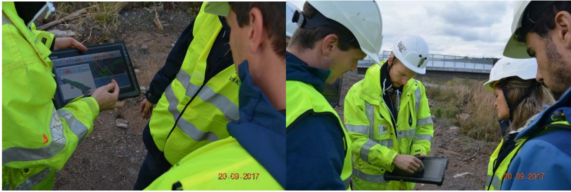
Figur 18 Visning av funksjonen på programmet som dei brukar ute på anlegget.
