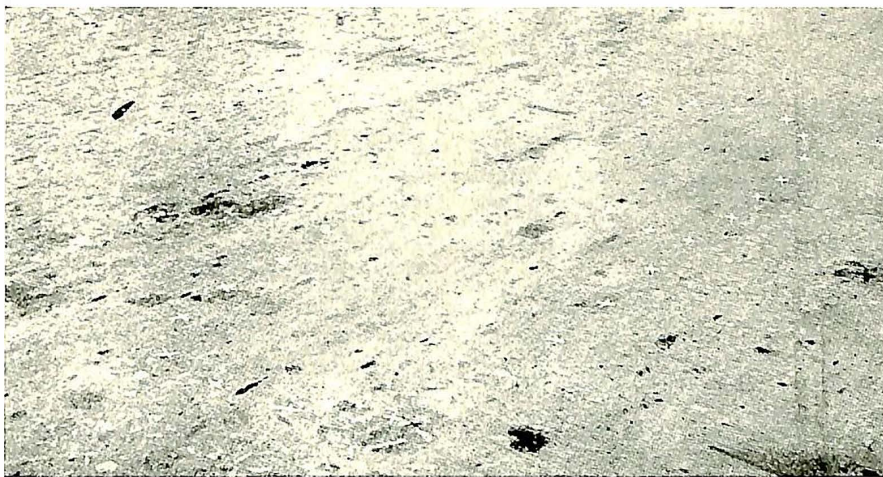
Hvordan et betongdække bør repareres. De hvite kors avgrensar et uthugget og senere istøpt stykke.
