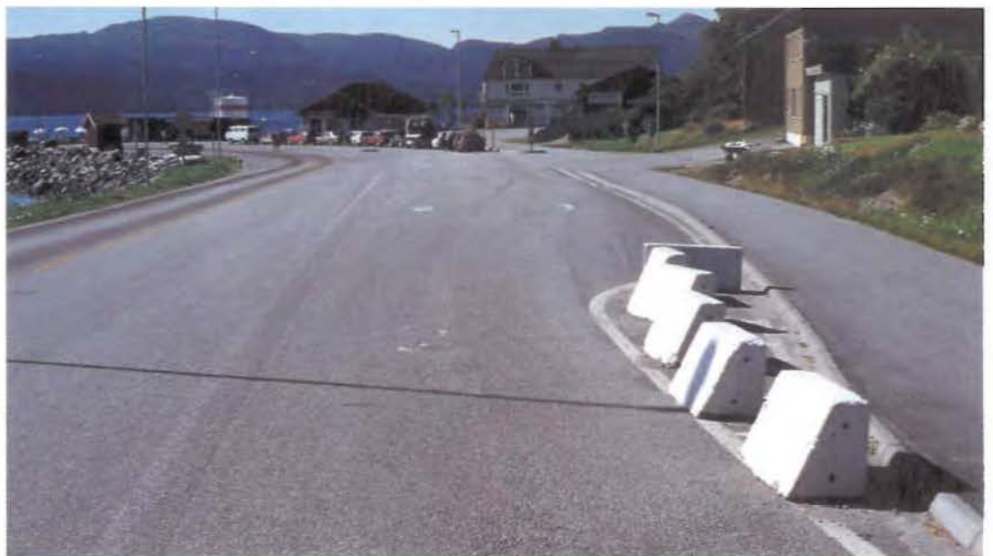
Eksempel på misbruk av betongelementer. "Midlertidige tiltak blir ofte stående!"
