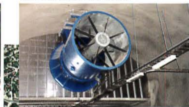
Vifte i Strømsåstunnelen
