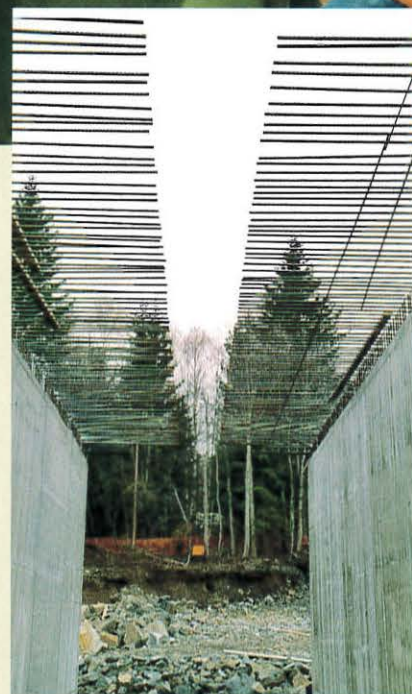
Kulverter som dette skal det bygges en del av på ny E 134 i Øvre Eiker.
