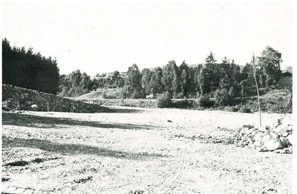
Fyllinga i Buaevje sett mot nåværende rv. 359. Den lange staken med flis på i høyre billedkant, angir senterlinje og fyllingsnivå for den nye riksvegen. (Foto: T. Malmanger)
