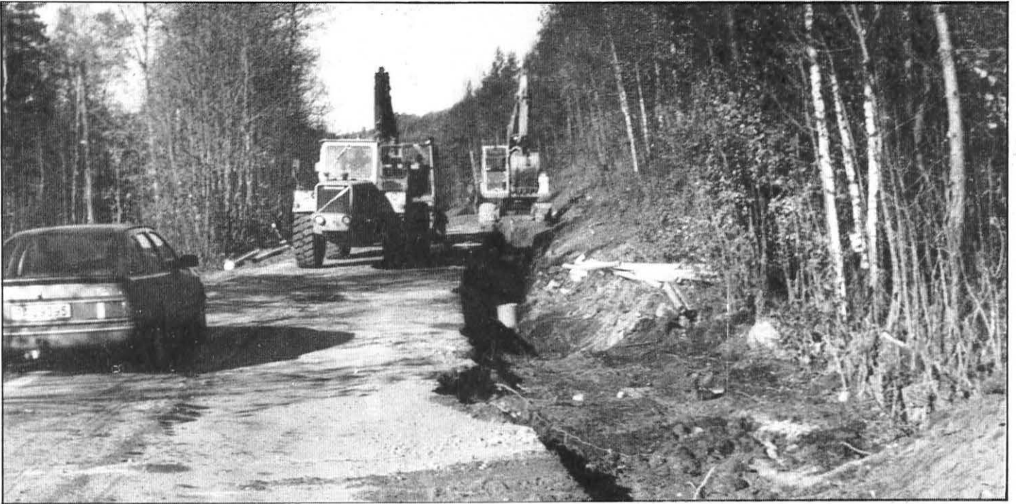
Fra arbeidet med legging av kloakkledning langs gamle E18 på Lohne i Søgne. Mens arbeidene pågår er det ingen sikring, men dette kommer på plass når arbeidsdagen er over.
