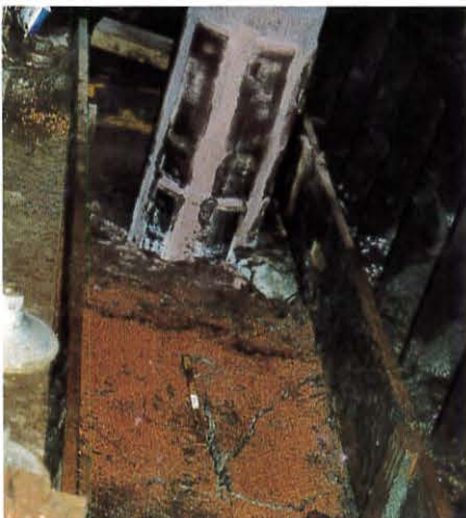
Grunnen begynner å sprekke
