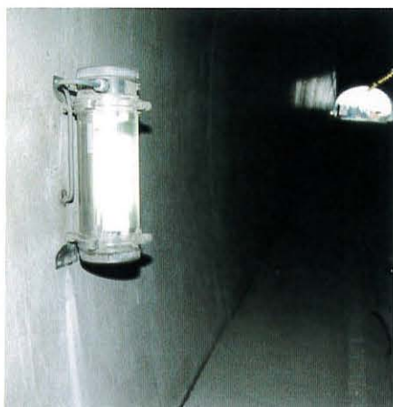
Rømningslys hver 50 meter
