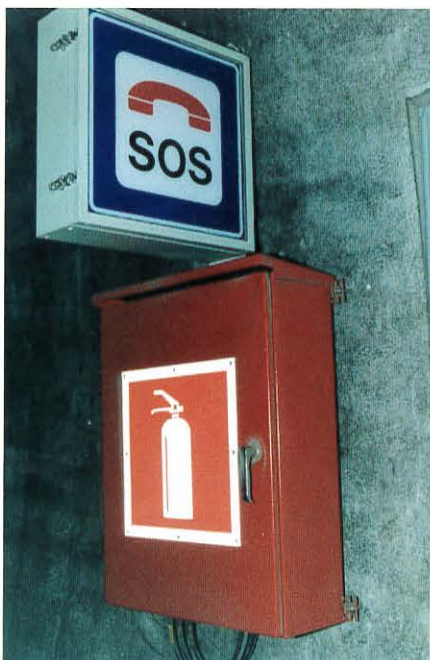
Brannslukkingsapparater og nødtelefon som dette blir det mange av gjennom hele tunnelen.
