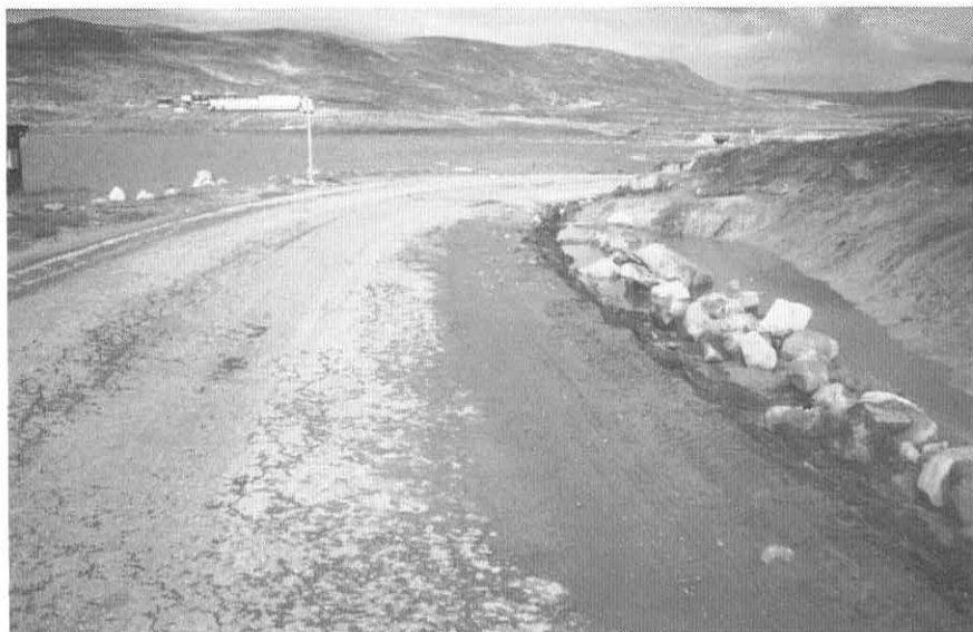
Et typisk eksempel på årsaken til skadene på vegen over vidda.
