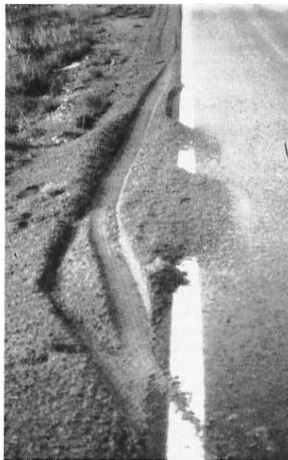
Et typisk eksempel på hvordan det ikke bør være. Løse banketter kan ofte være trafikkfarlig. (Foto: Frithjof Indseth.)
