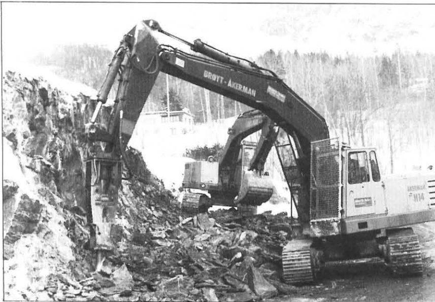
Bruk av hydraulisk pigg har vist seg å bli svært rimelig sammenlignet med andre metoder.
