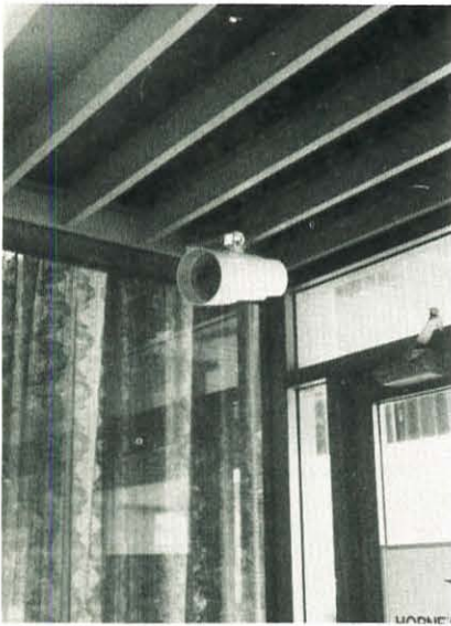
TV-kameraet overvåker inngangen til vegkontoret.
