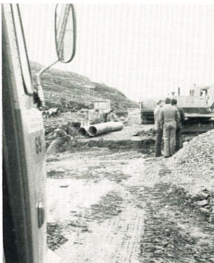
Og her var det stopp. Vegsjef, vedlikeholdssjef og adm. sjef studerer moderne rørlegging.
