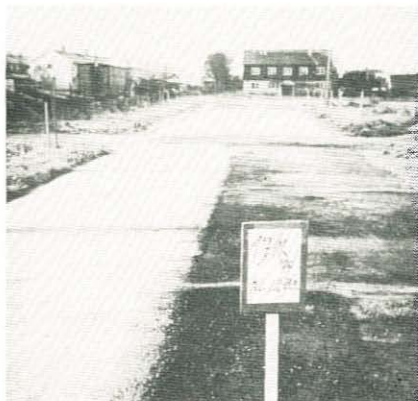
Issingssituasjonen på forsøksveg 17. november 1974 kl. 12.30 i Trondheim. Høyre veghalvdel er bygget opp med grus under asfalten. Venstre veghalvdel er bygget opp med stein.
