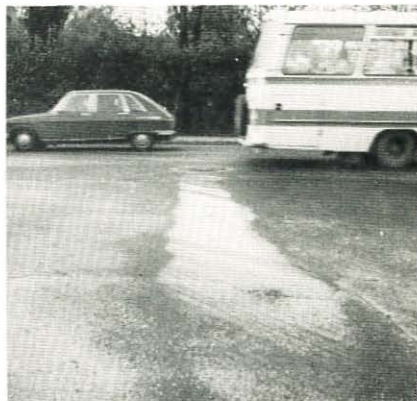
Ved gjenfylling av grøften benyttes ofte grovere materialer enn de som ble gravd ut. Dette gir økt ising på vegoverflaten fordi dekketemperaturen her blir lavere.
