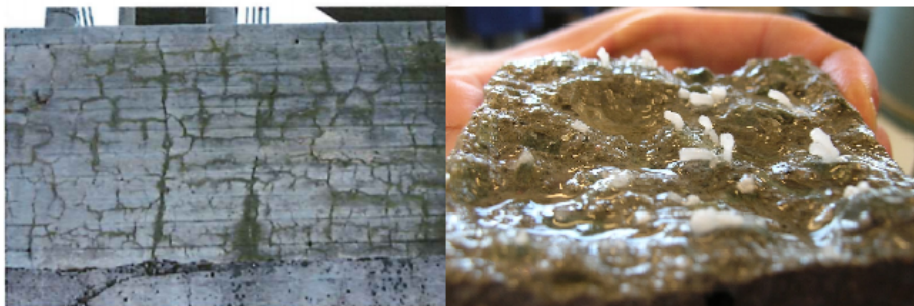
Figur 3.3: Ytre riss forårsaket av ekspansjon av silika-gel i betongen
