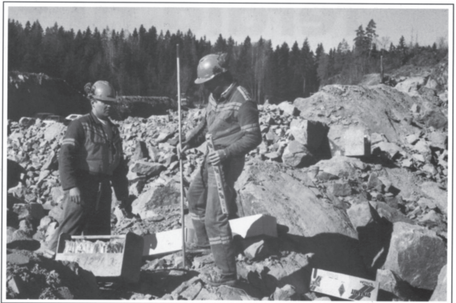
Sprengningsgruppa "The big band" har utarbeidet varslingsrutiner, sjekklister og informasjonsark om hvordan man skal forholde seg ved sprengning på og ved anleggsplassen, f.v. Bent Gunnerød og Jan Egil Blix.
