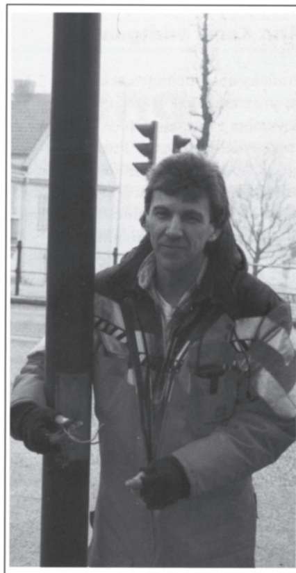
Ved Hotell Klubben har elektriker Svein Svensvik fjernet trafikklysene mens arbeidene pågår.
