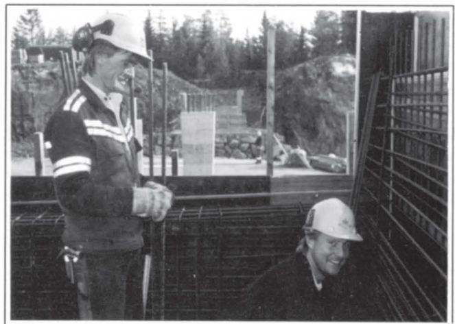
Tore Dybendal og Gunnar Moen i ferd med å binde jern på Fjellskarveien bru, som skal gå nesten 10 meter over E 18.
