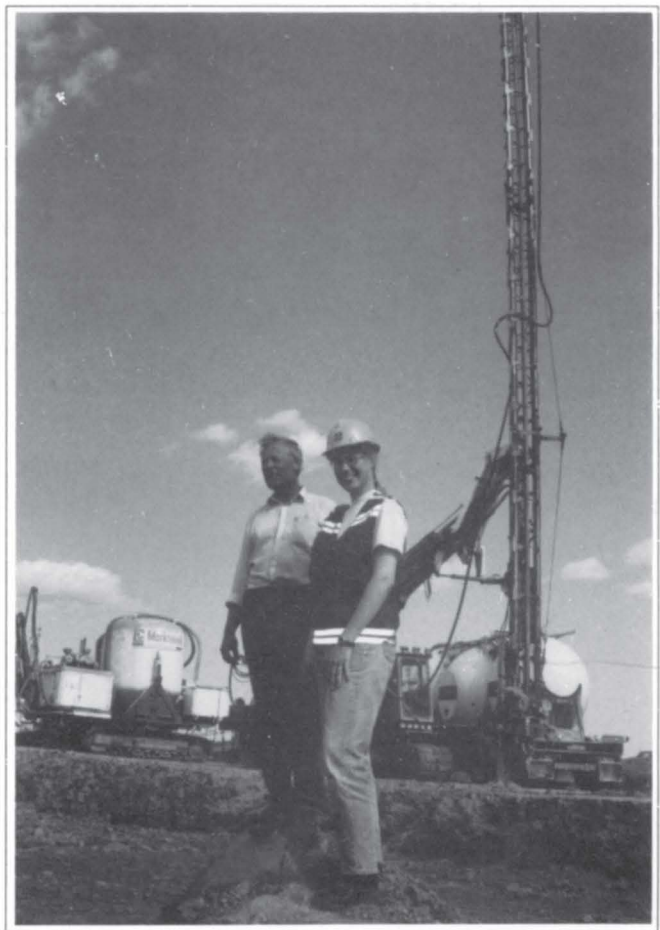
Kristi Kvernevik sammen med bas på anlegget, Torbjørn Severinsen, foran en av riggene som skal brukes til sement/kalkpæling i krysset mellom FV 275/285..
