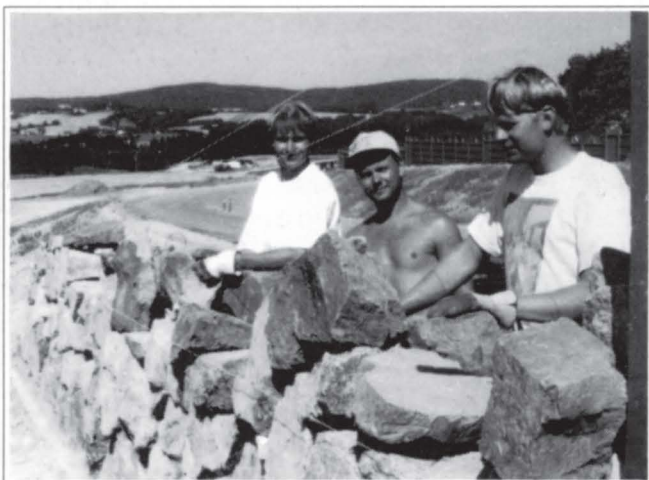
Vestfold Hage & Anlegg fra Sandefjord lager her en endemur på en av støyskjermene på vegen mellom ny og gammel E 18. På bildet ser vi f.v. Kjell Einar Vestrum, Ken Roar Riis og Are Ruud.
