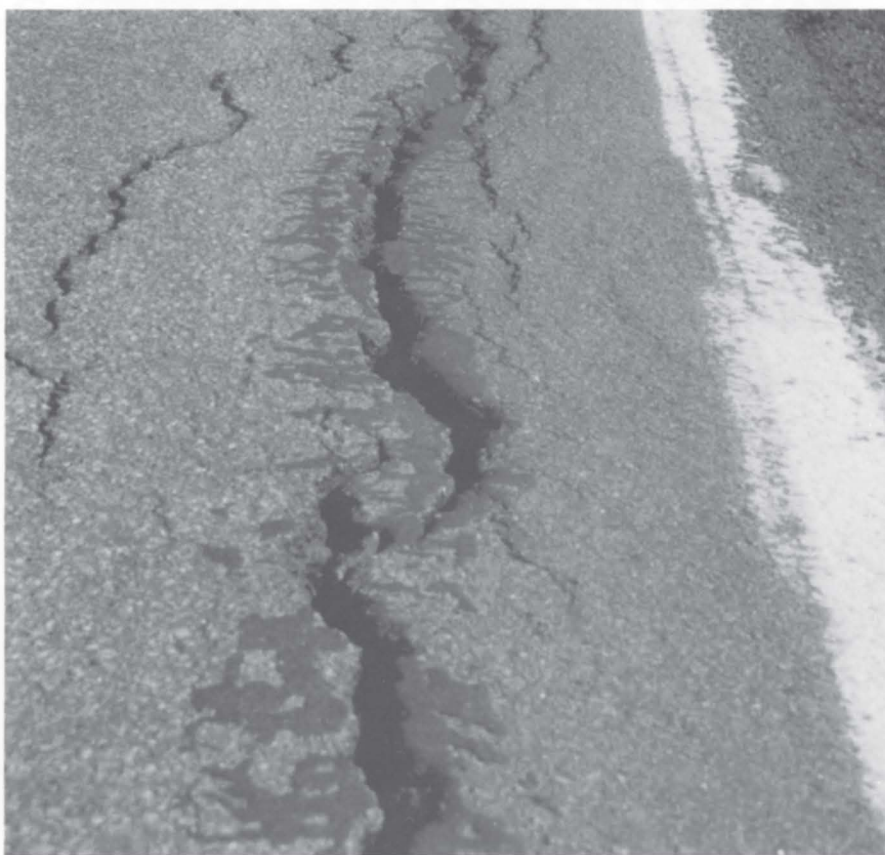
Driftssjef Nils I. Skjevik har aldri sett så store vinterskader på vegnettet som i år. Snøvinteren har også medført at det er mindre penger til å utbedre skadene.
