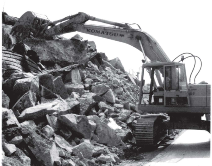
3500 kbm fjell skal bort for å gi bedre sikt på Fokserød på E 18-parsellen nord for Sandefjord.
