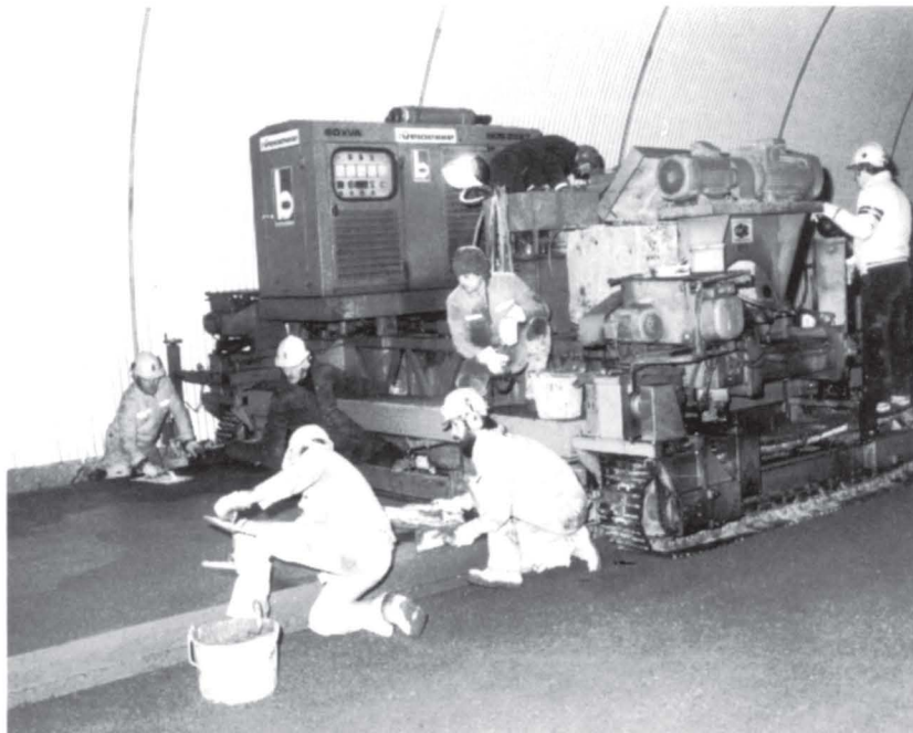
Det er ikke økonomisk og teknisk forsvarlig å vedlikeholde betongdekket i Holmestrandtunnelen. Bildet er fra dekkeleggingen i 1983.
