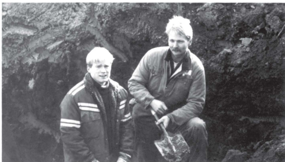
Ved Langgrunn måtte de fjerne endel gammel betong lagt av tyskerne under krigen, for å få lagt ned nye ledninger og kabler. Her er Trond Bergstrøm (t.h.) og Espen Sørli i full gang i grøfta.
