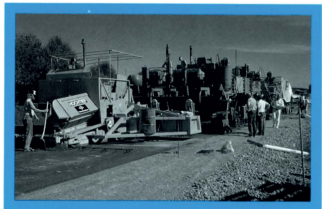
Betongdekkene som legges i dag er beregnet å skulle kunne slipes ned tre ganger. Dette er imidlertid en kostbar prosess.
