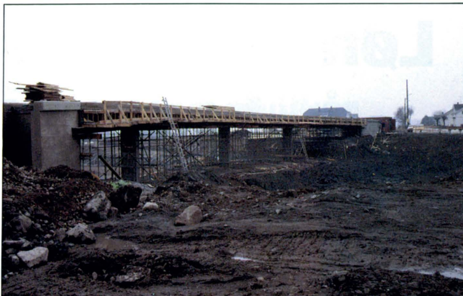
Ramnesvegen gang- og sykkelvegbru er den første som er bygd etter åpen anbudskonkurranse hvor Statens vegvesen deltok på lik linje med private entreprenører. Etatens eget anbud var det laveste, og arbeidet er derfor utført i egenregi.
