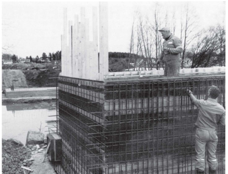
Arbeidene på nye E-18 i Sem kom i gang tidlig på året. Brua over Aulielva var det første større arbeidet som kom i gang på denne parsellen.
