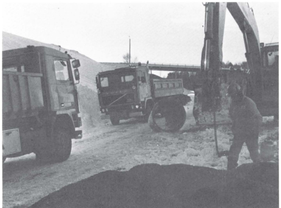
E 18 anlegget i Sandefjord vil bli avsluttet i løpet av året. Etter planen skal vegen åpnes i oktober.
