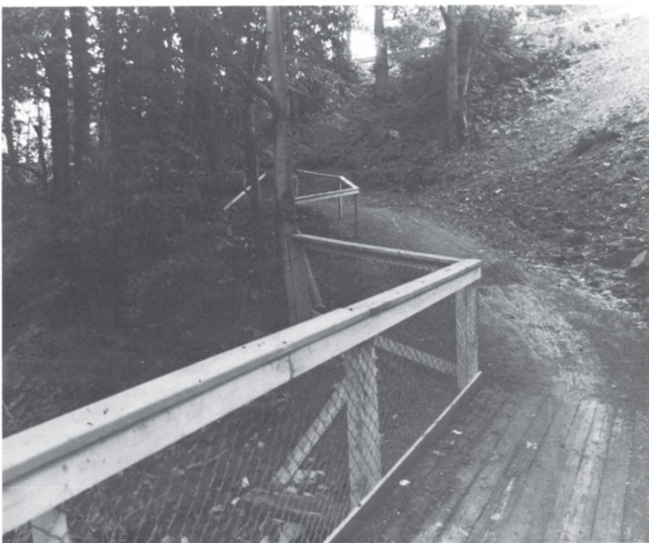
Det var ikke bare ny bru som ble bygd, men det måtte også bygges en ny veg i elveskråningen på begge sider.
