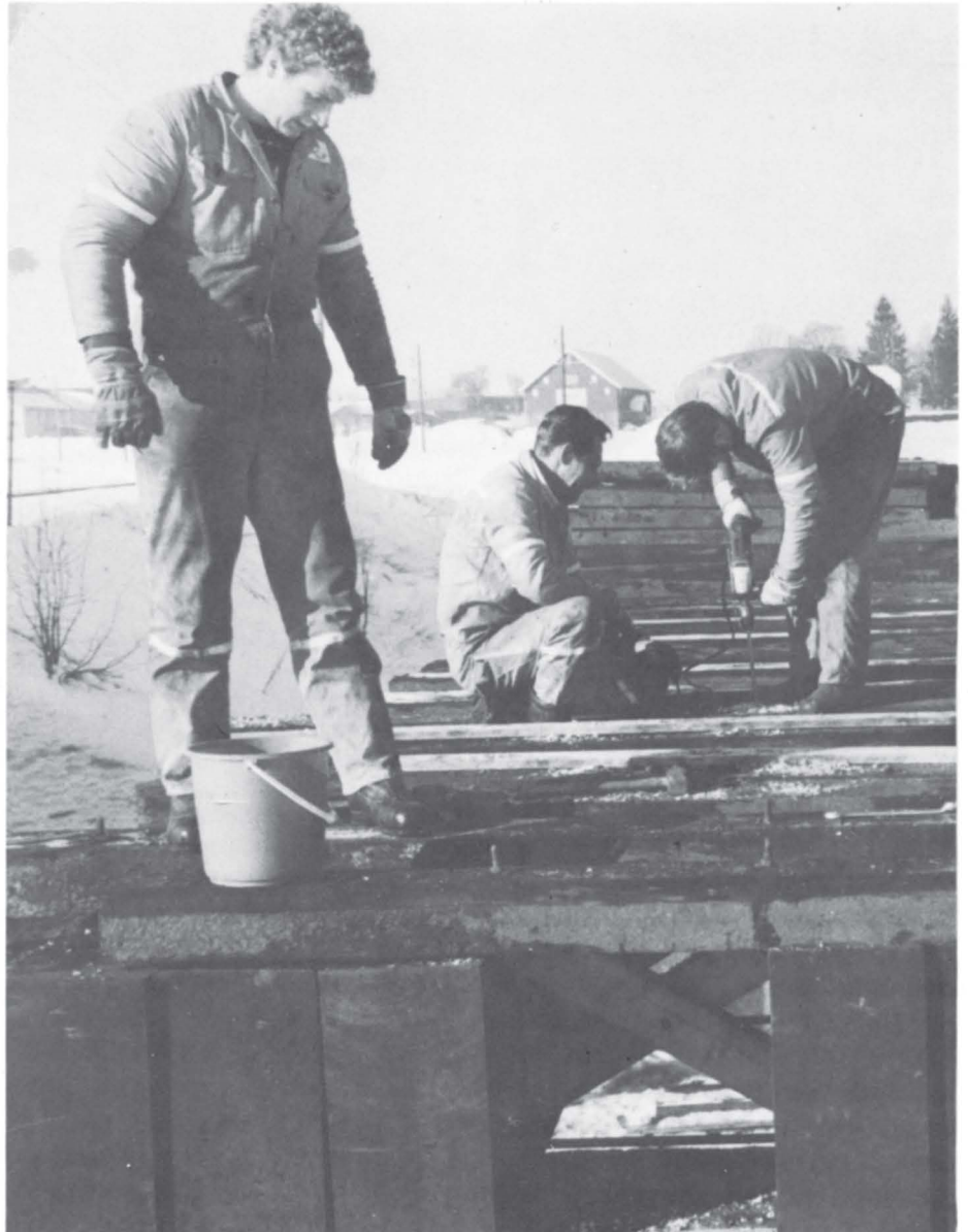
Henk Samnøy er en av lærlingene. Han har jobbet på Aulibrua siden i vinter.
