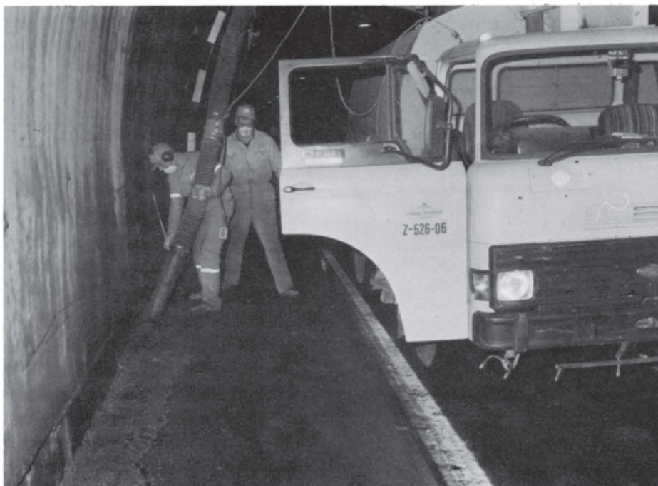
Slam og skitt som blir spylt vekk fra tunnelveggene kan ikke bli liggende på banketten, men må fjernes.
