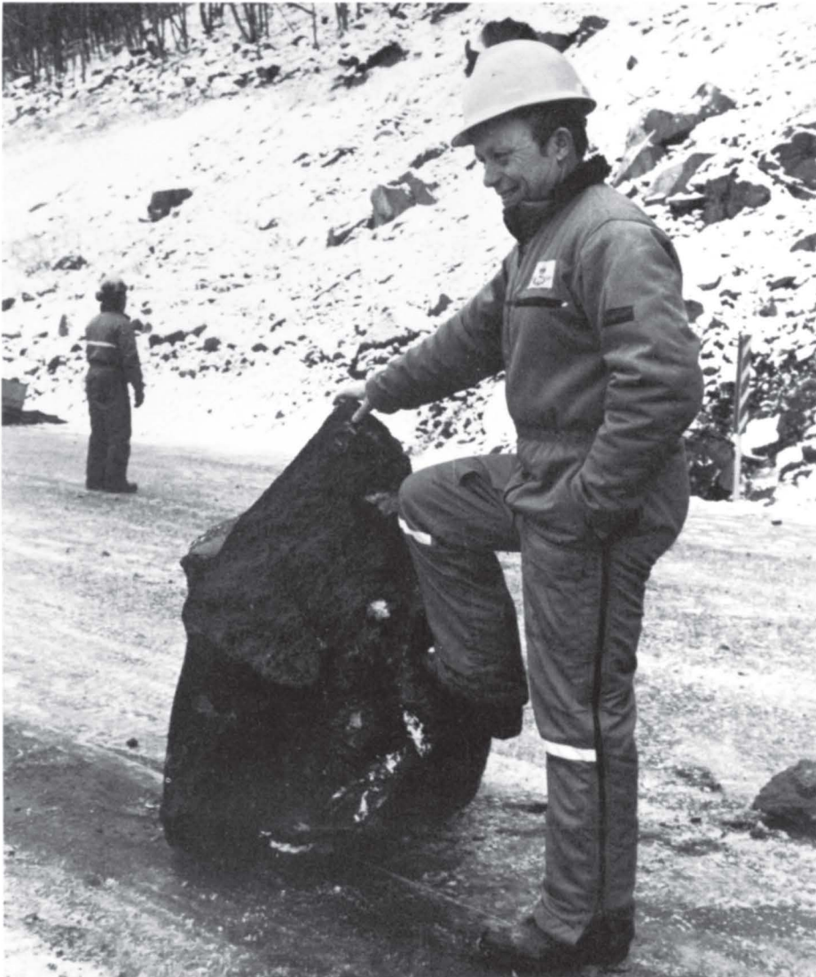
Rolf Sommervik fikk mange timers arbeid i forbindelse med ras, rensk og sikring langs E 18 i Holmestrand i løpet av 1984.
