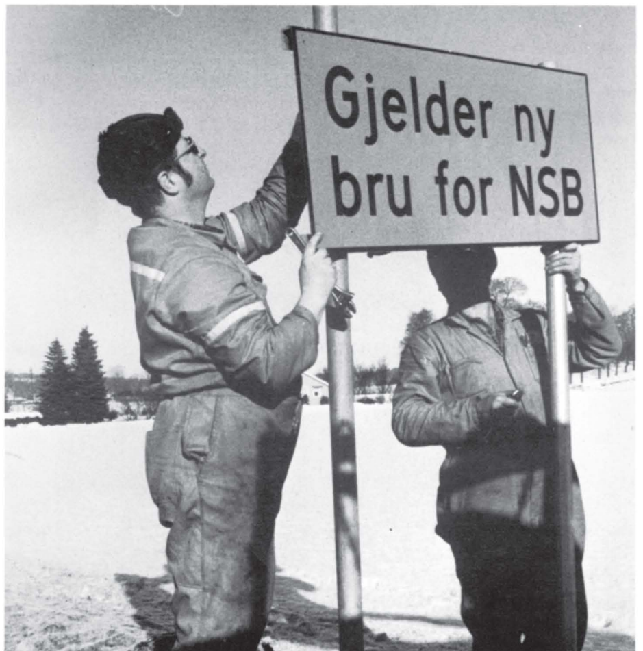
Skiltseksjonen hadde en hektisk jobb for å skille den nye høyden i undergangen. Her er Asbjørn Hagen t.v. og Erik Jespersen i gang med oppsetning av ett av de midlertidige skiltene.
