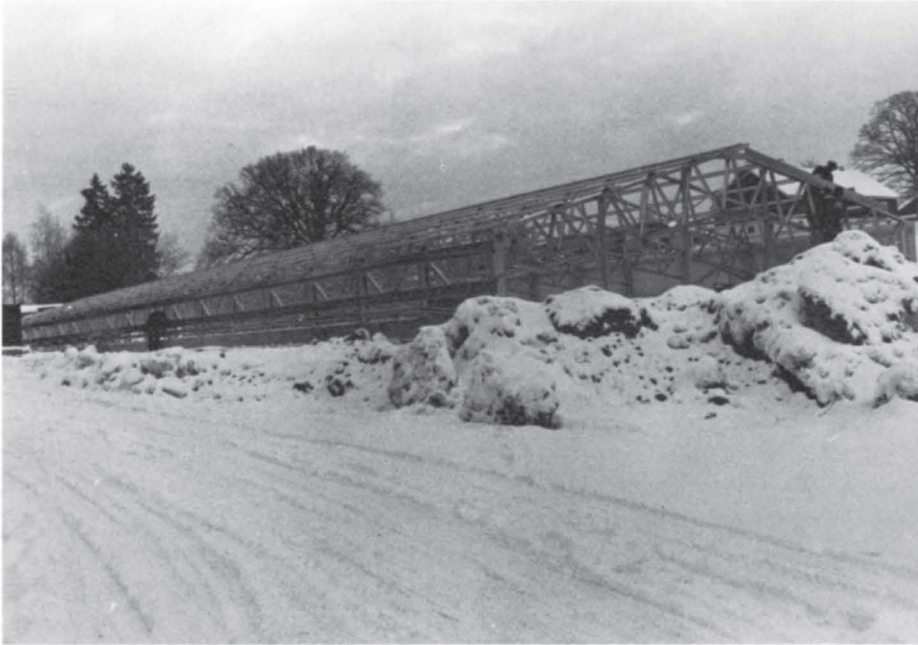
Drivhus på vegsentralen? Selvfølgelig ikke, dette er bare første fase i byggingen av den nye lagerhallen.
