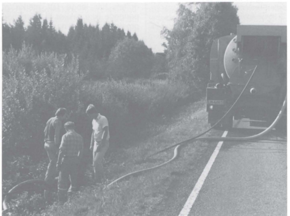
Spyling av stikkrenner, en av mange oppgaver for vedlikeholdet.
