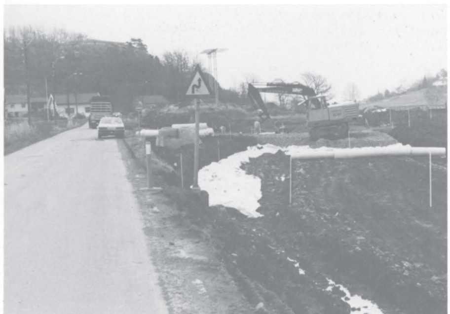
Allerede nå er arbeidene på Rv. 303 startet opp ved Nilsesvingen. Til sammen skal det i 1984 brukes 11 mill. kroner på Gokstad-veien i Sandefjord.
