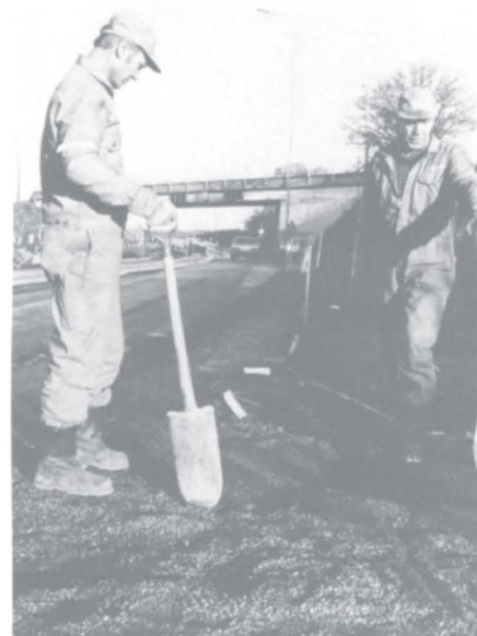
Torleif Eriksen til venstre og Sverre Larsen diskuterer hvordan arbeidet med nedlegging av kum i vegkanten ved innkjøringen til Kjellekiosken skal gripes an.
