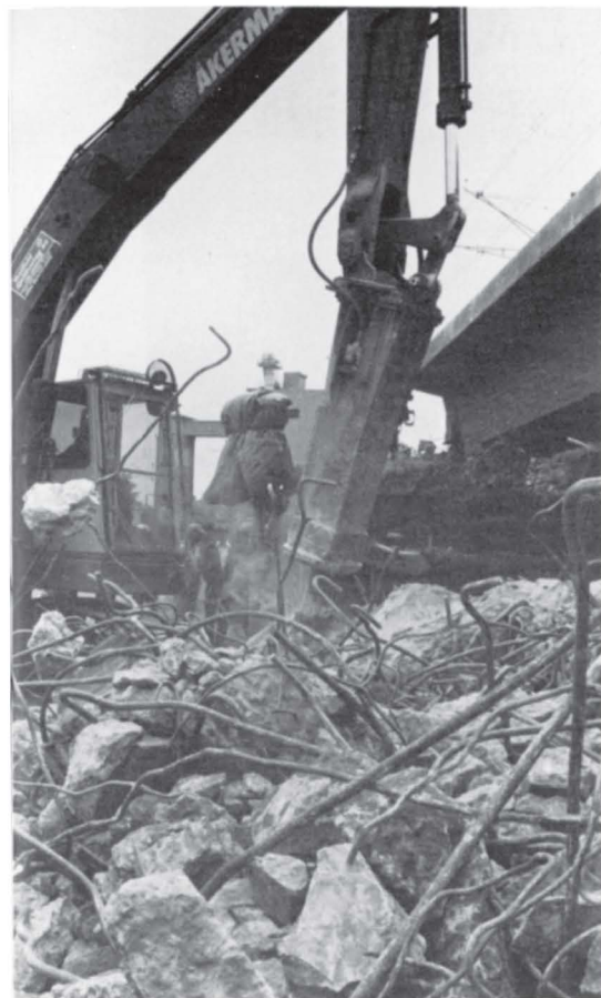
Den gamle brua var kraftigere armert enn beregnet.
