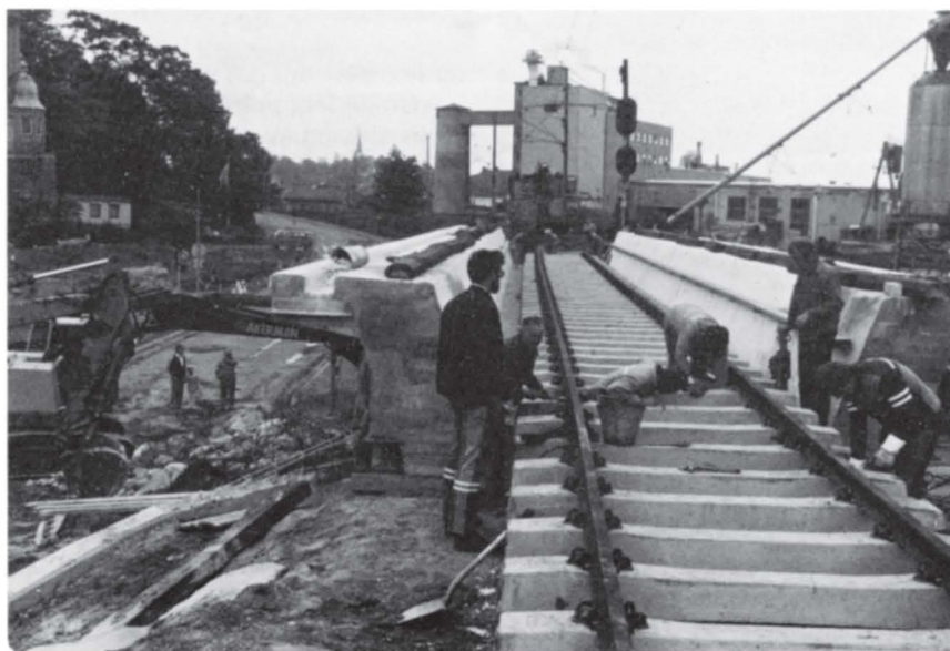
Den nye brua er på plass. Jernbanens folk er igang med montering av skinnegangen.
