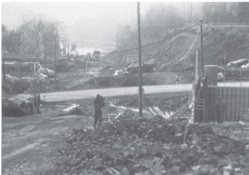
Fra anlegget ved Bleikvollen.
